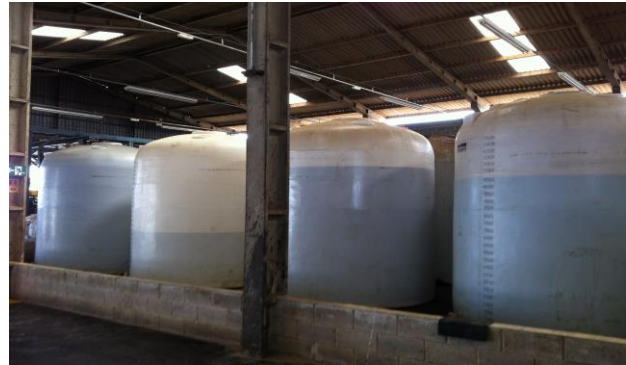
Vorratsbehälter während des Besuchs: mit Sicherheitsbehälterwandung
