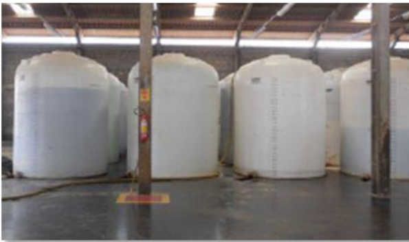
Vorratsbehälter bei der Umwelt- und Sozialprüfung: ohne Sicherheitsbehälterwandung
